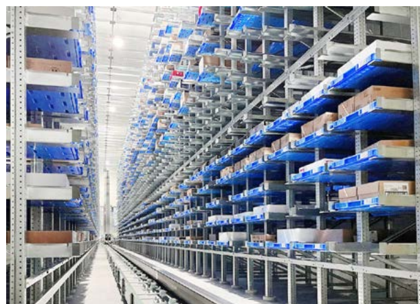
Cámara frigorífica automatizada con más de 26 280 ubicaciones de almacenamiento de bandejas. (Fuente: Früchte Jork).
